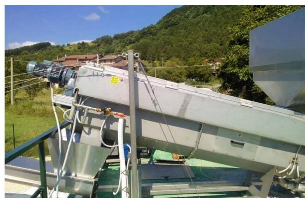
Deshidratación de fangos en EDAR urbana
